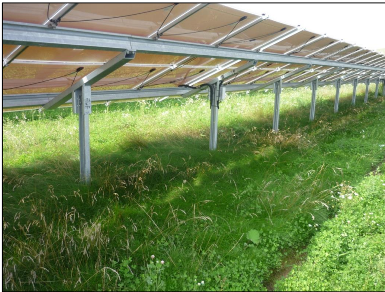
Abbildung 7: Beispiel der Aufständigung von Solarmodulen (Bereich Solarpark Ronneburg Süd).
