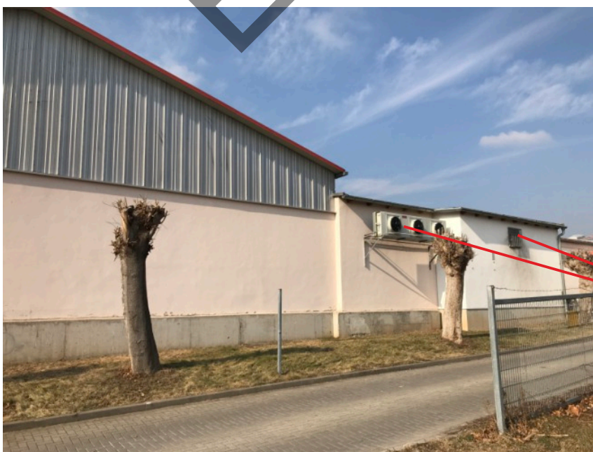
Rückkühler und Lüftungsöffnung ALDI
