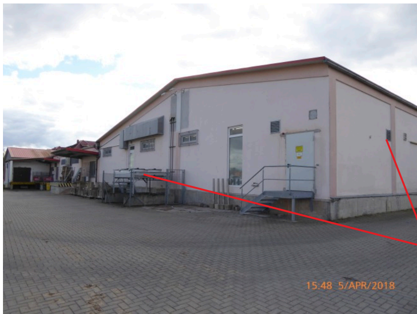
Rückkühler und Lüftungsöffnung EDEKA
